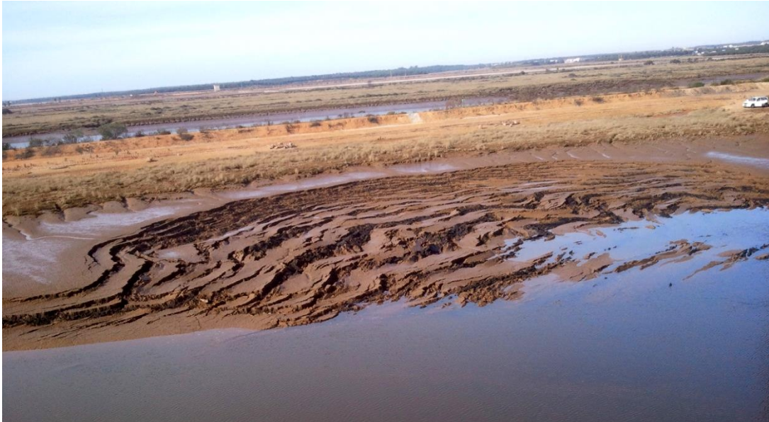
Figura 1. Deslizamientos generados en la orilla debidos al descalce de la misma por erosión en el margen del canal durante una avenida del Odiel.
